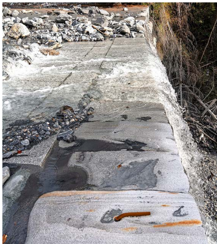
Teilsanierung der Abflusssektion von Sperre Eins: Während im Vordergrund noch funktionstüchtige, bestehende Natursteinblöcke zu sehen sind, fliesst das Nollawasser im Hintergrund bereits über ein neu verlegtes Natursteinbett.
